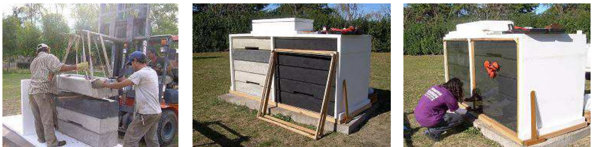
Fig. 8: Montaje de los BOX con la instalación completa de los MAC (Sólido y mixto pigmentado y sin pigmentar) y sensores.
